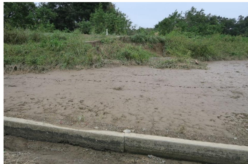
地点③(10月14日撮影) 堤防の川裏法面の洗掘(侵食)痕跡。神戸地区の都幾川右岸堤防とその周辺では、越水・溢水が発生した痕跡が多数の地点(区間)で認められた。
