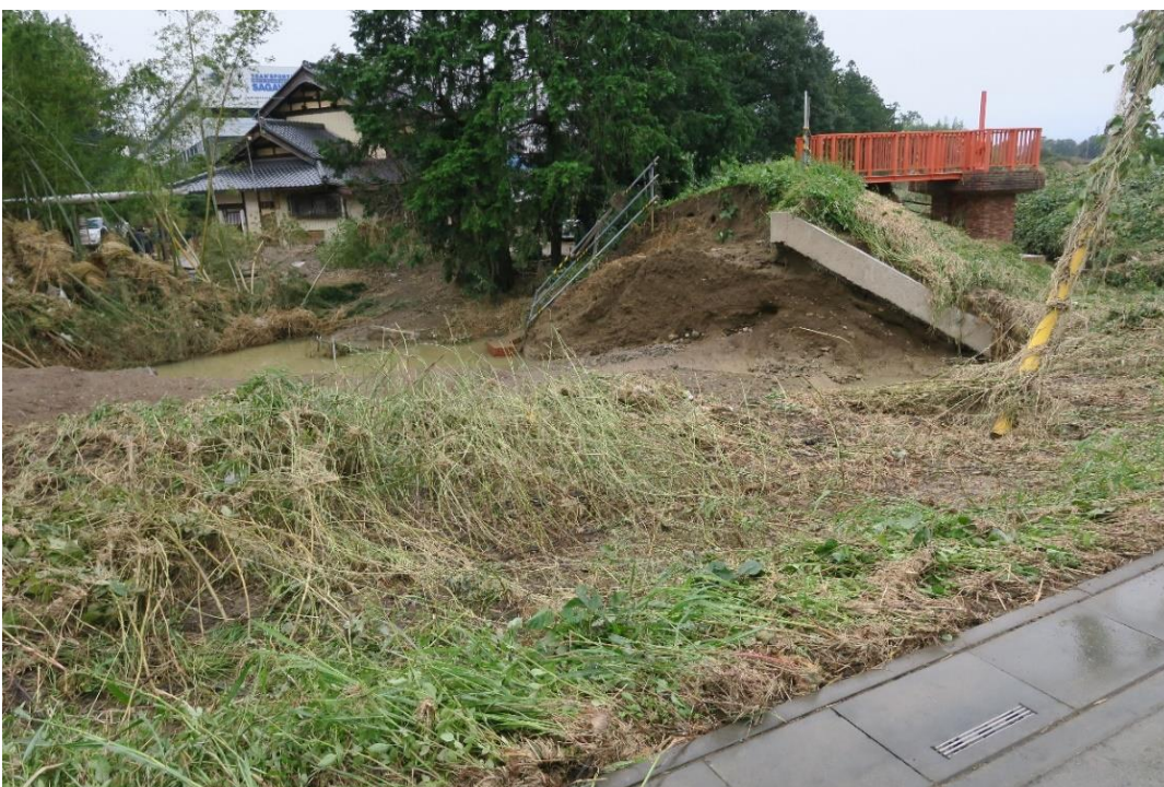
地点⑦(10月14日撮影) 堤内地に存在する都幾川旧堤防(治水地形分類図による)の破堤。破堤地点上流側(写真奥側)の樋管(奈目曾樋管)は1903(明治36)年に建設されたものであり(是永 1997)、この付近で農業用水路が合流、分岐している。
