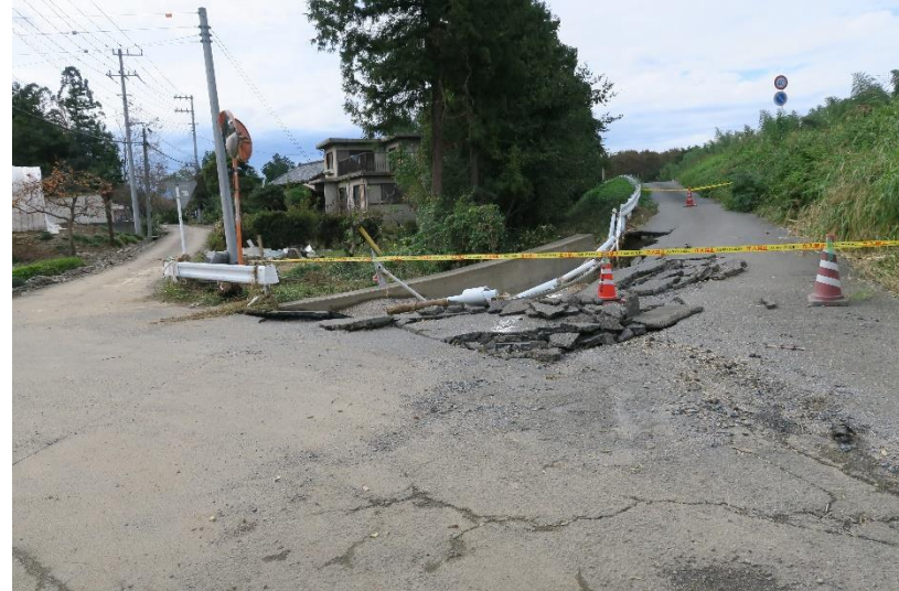
地点⑧(10月20日撮影) 水路沿い道路路肩の損壊。写真右側は都幾川堤防(県道41号線)、左側は山麓堆積地形で、その間の狭窄部を水路が流下しており、その水路沿いの家屋や道路等構造物に被害が生じた。
