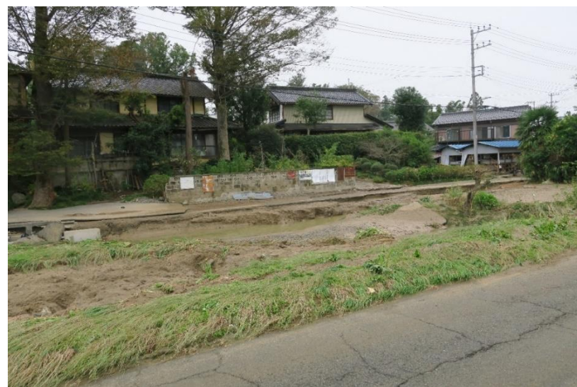
地点⑨(10月14日撮影) 水路に生じた洗掘(写真⑧の下流側)。この下流側には多量の土砂の堆積がみられた。
