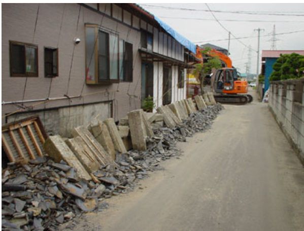
家屋被害写真
