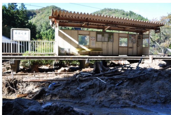
写真3 滝ノ上付近の私鉄駅の被災状況
