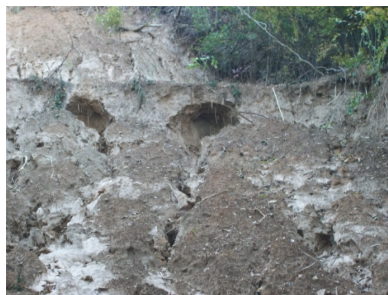
写真 18 写真 17 の崩壊源頭部
