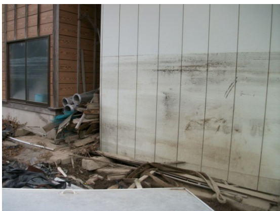
写真11 自然堤防上の家屋の浸水痕
