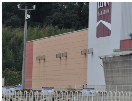
写真 14 ホームセンター外壁の浸水痕
