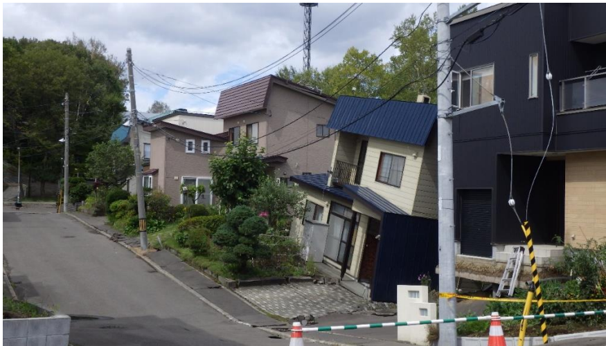
写真 1-2 大きく手前方向に傾いた建物を中心に左右方向に帯状に大きく沈下している
