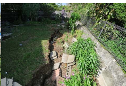
写真5 敷地での亀裂⑤ ※2016年4月22日撮影
