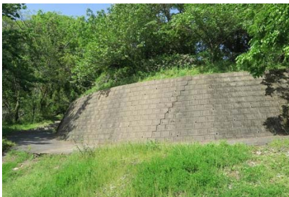
写真1 壁面の亀裂① ※2016年4月22日撮影
