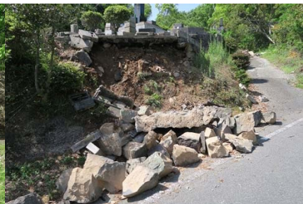
写真2 小規模崩壊② ※2016年4月22日撮影
