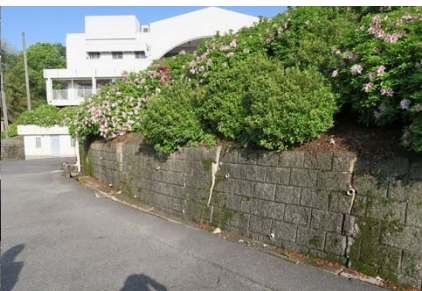
写真8 壁面の亀裂⑧ ※2016 年 4 月 22 日撮影
