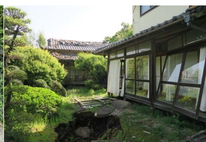
写真6 敷地での陥没⑥ ※2016年4月22日撮影
