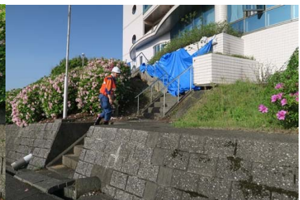
写真9 ずれ落ちた階段⑨ ※2016 年 4 月 22 日撮影
