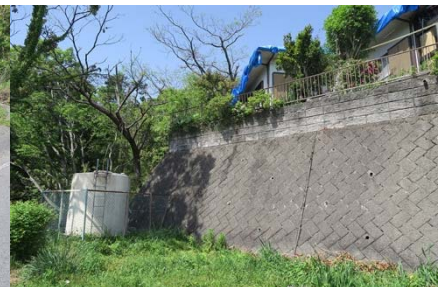
写真3 敷地での亀裂③ ※2016年4月22日撮影
