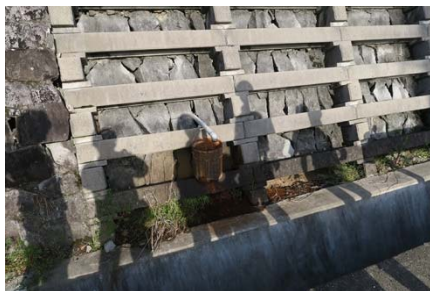
写真7 壁面からの湧水⑦ ※2016 年 4 月 22 日撮影
