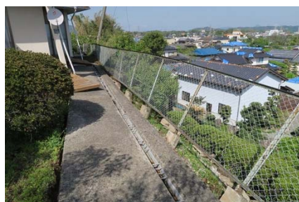
写真4 敷地での亀裂④ ※2016年4月22日撮影
