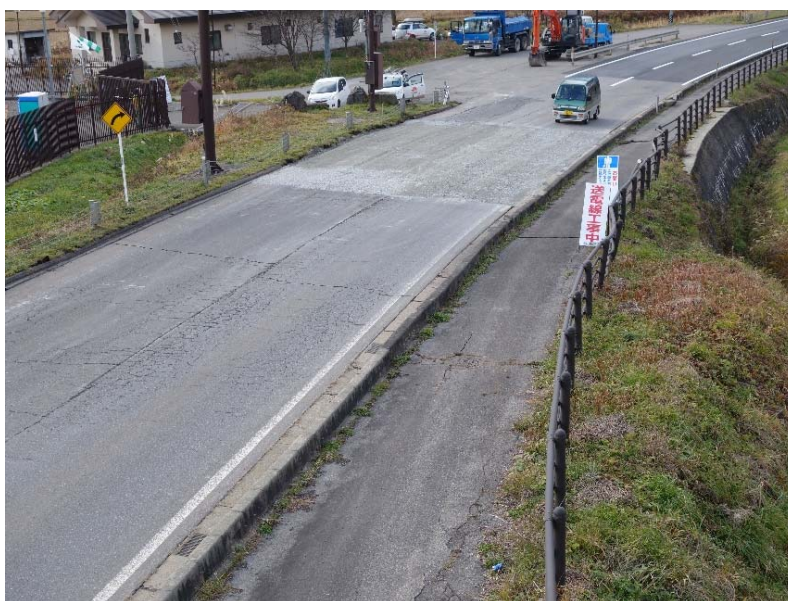
写真 3 : 道路上における水平短縮の可能性のある変形 (神城地区の東西方向の道路上)
