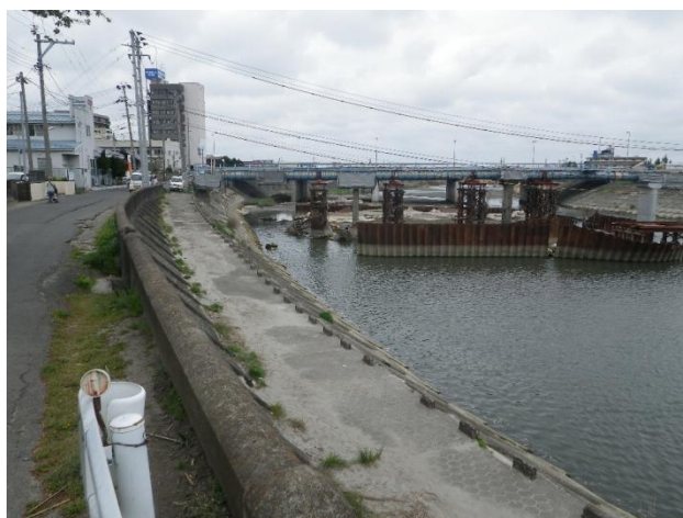
写真A-2 堤防の外側に堆積する海砂。
