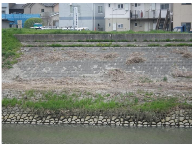
写真B-1 梅田川堤防の外側に堆積する稲わら。堤防の上面から約1m下まで認められる。
