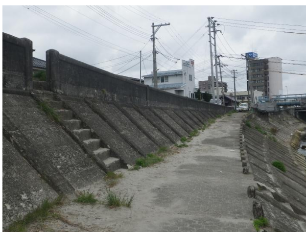
写真A-3 堤防の外側から道路に通じる階段にも砂が堆積している。この通路から水があふれたと考えられる。
