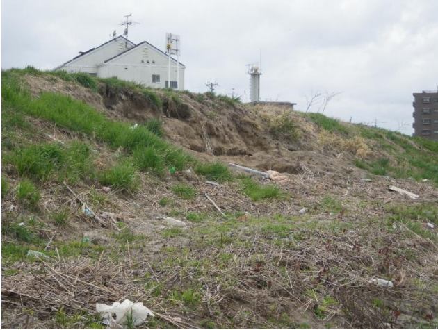
写真B-5 堤防先端付近に残る崩壊の跡。津波が引いた後にパイピング現象が生じたと考えられる。
