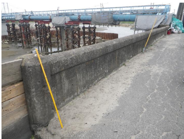
写真A-1 堤防の道路側に堆積する海砂。木で塞がれた通路から水があふれたと考えられる。
