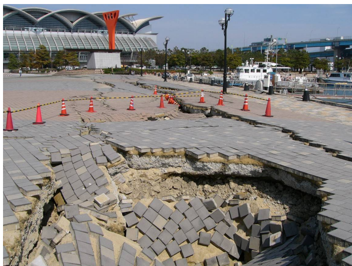
写真4 博多埠頭におけるブロック舗装面の陥没 (2005年3月21日 後藤撮影)
